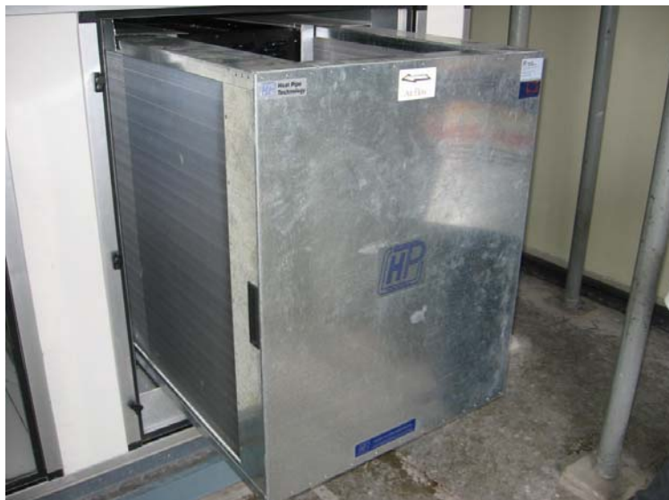
รูปที่ 5 แสดง ฮีทไปป์ ซึ่งติดตั้งอยู่ภายในเครื่องเติมอากาศ
